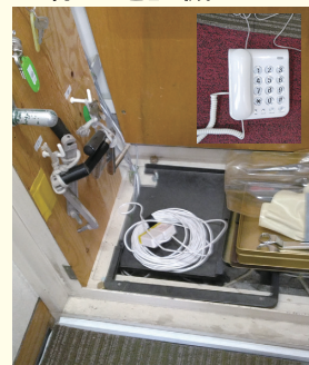
災害時用公衆電話の回線と電話機
